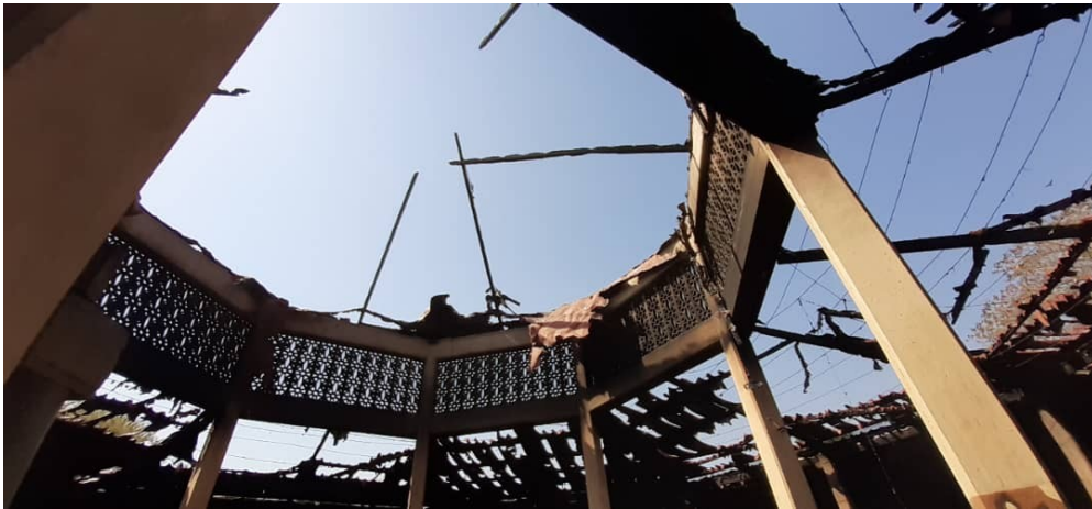
Le toit de l'église a été complètement détruit
