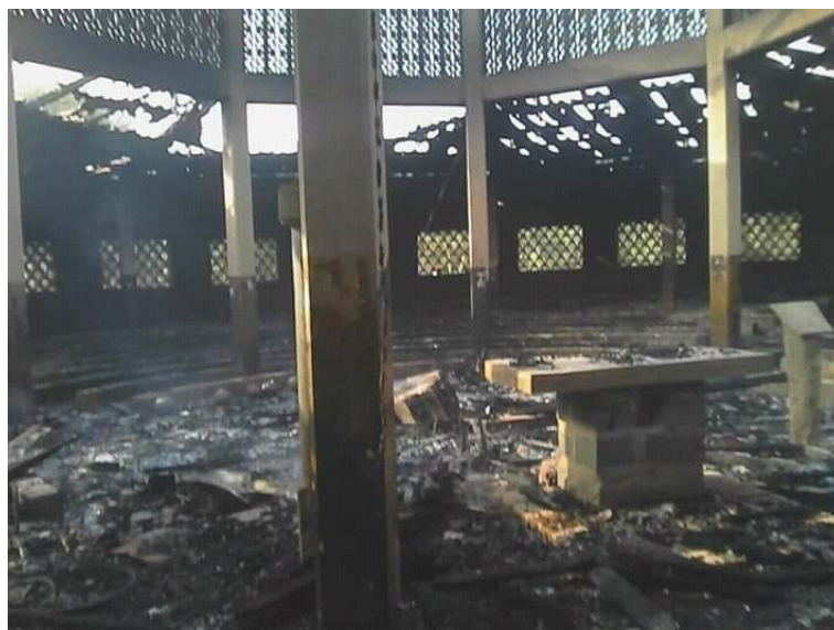
Les dégâts à l'intérieur de l'église
